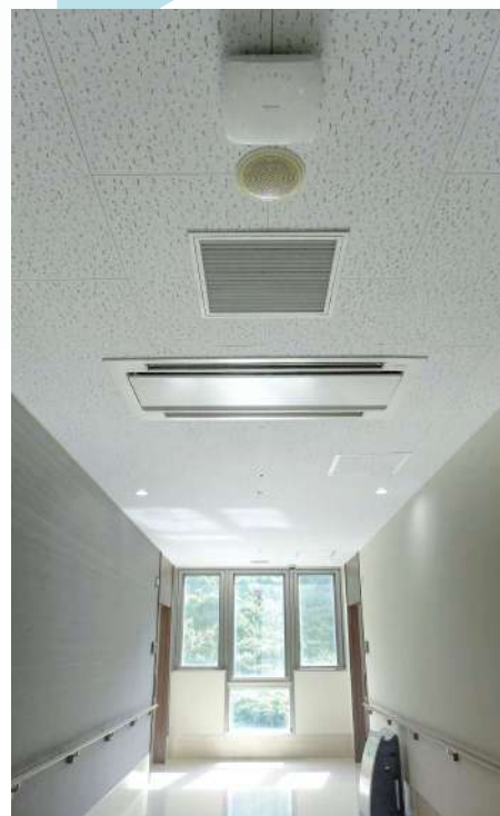
廊下天井部に設置されたAIRRECT AP-6410
